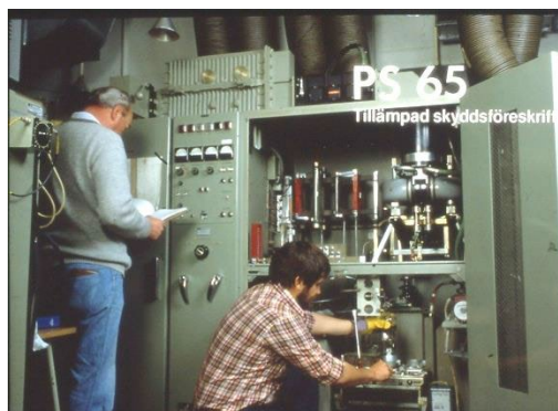
Underhåll i apparatrum
