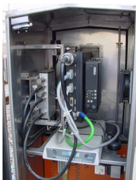
Radio installerad i tåg.
