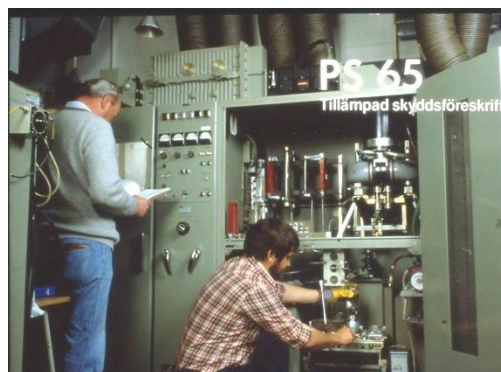
Underhåll i apparatrum
